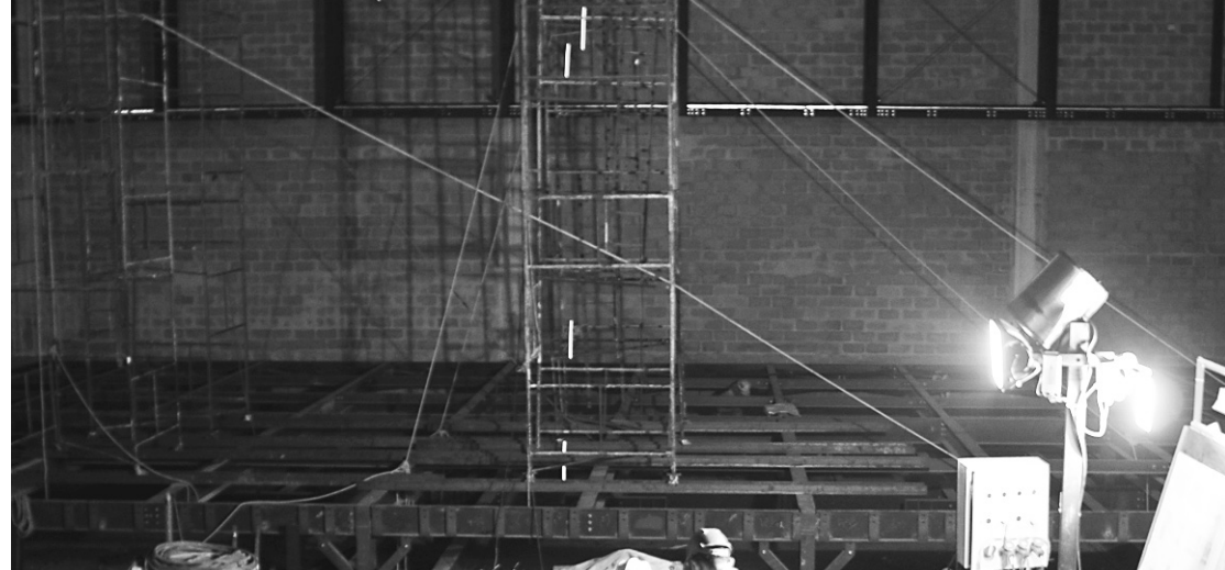
Operários trabalham na construção do teatro, a maior obra do terceiro piso
