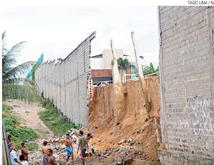
▶ Muro do Condomínio Ponta Negra Boulevard desabou com as chuvas
