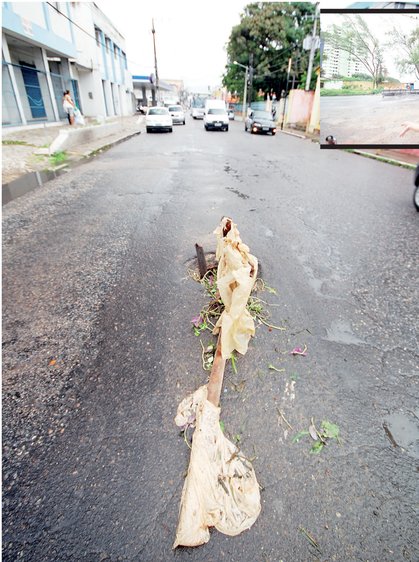
▶ Na Avenida Coronel Estavam, no bairro do Alecrim, próximo ao Colégio das Neves, o que era uma tampa de esgoto virou um buraco
