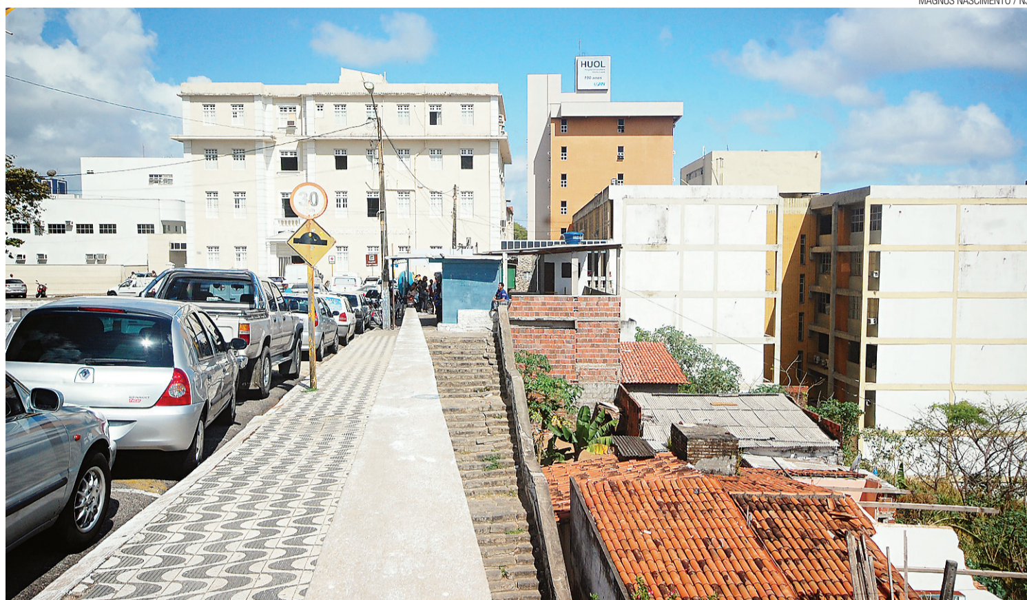
► Construção irregular estava sendo erguida atrás das quatro cigarreiras instaladas na calçada do Hospital Universitário Onofre Lopes
