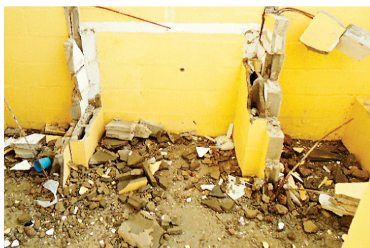
▶ Alojamentos e parte do novo pavilhão Rogério Coutinho Madruga já foram destruídos pelos apenados
