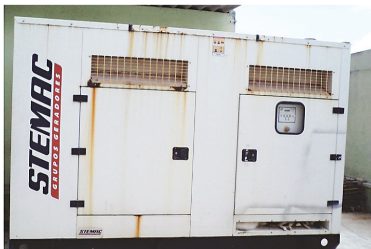
Gerador: transferido do hospital para uma UPA que não funciona
