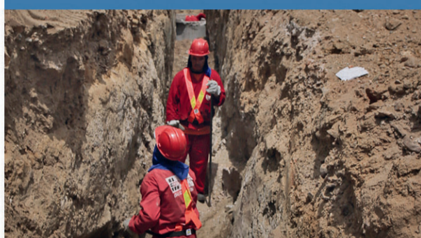
ESGOTAMENTO SANITÁRIO AREIA BRANCA
