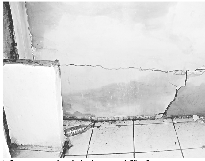
► Casas correm o risco de desabar com as infiltrações
