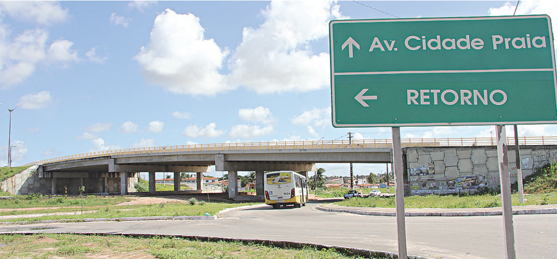
► O viaduto da Avenida das Fronteiras é a única obra do programa em Natal; mesmo assim está incompleto
