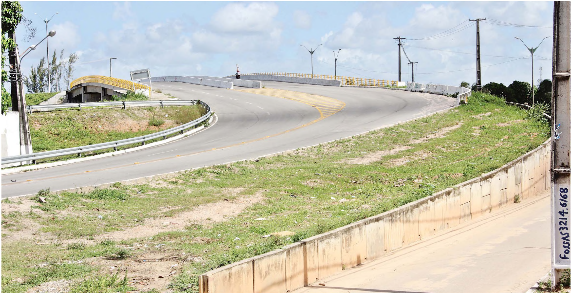
▶ Viaduto das Fronteiras, até hoje sem conclusão, vai ser terminado e pistas auxiliares também serão duplicadas
