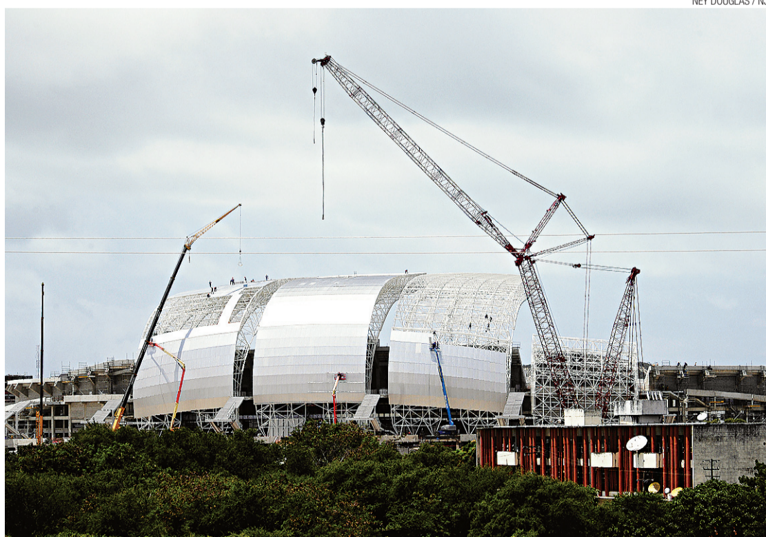
▶ A Arena no início da montagem do teto, com o guindaste girante 'Dragão Vermelho' em ação
