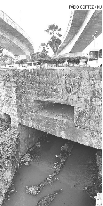
▶ Risco: laje sobre o Canal do Baldo apresenta rachaduras e tem ferragens expostas
