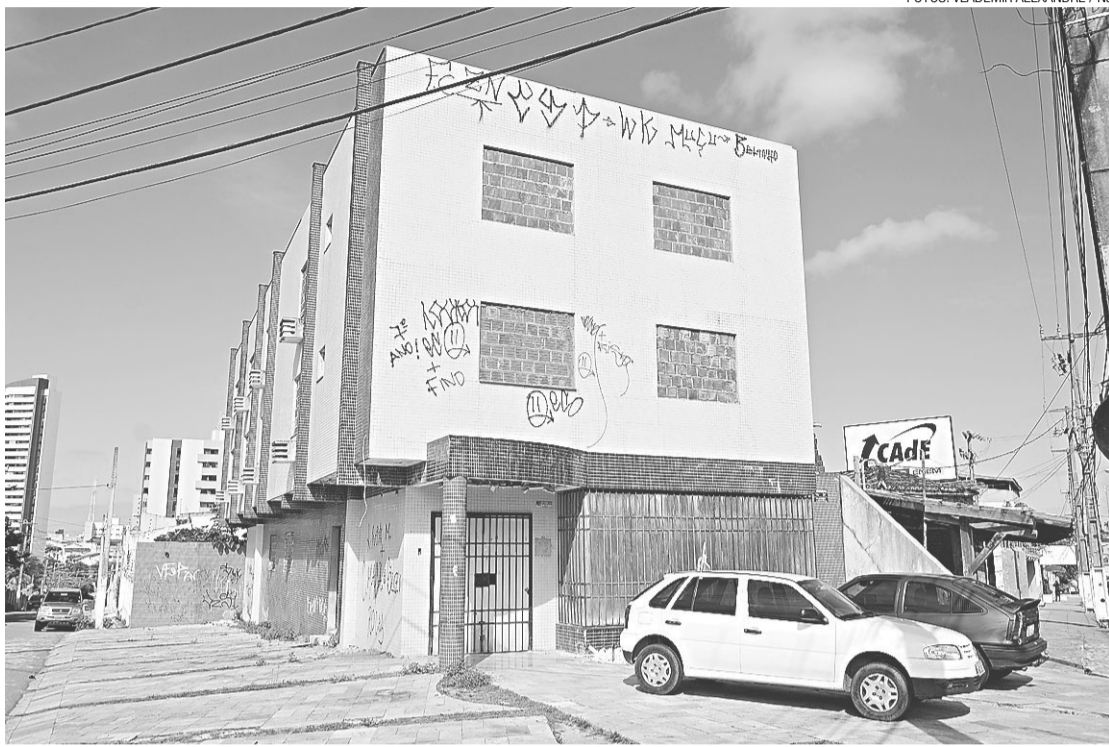
► Prédio foi adquirido por R$ 850 mil, abandonado; e agora deve requerer mais R$ 427 mil para ser usado
