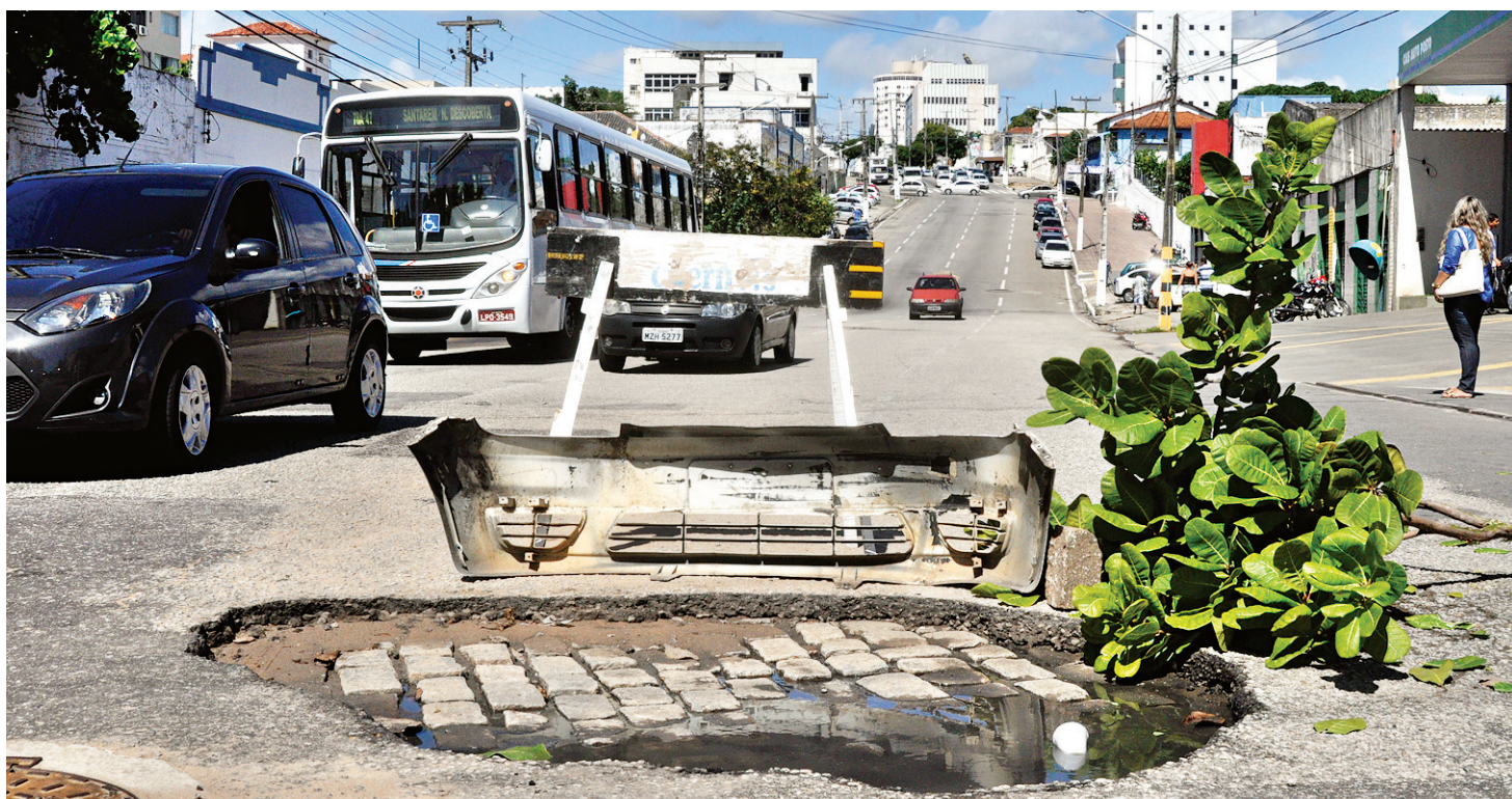
Cruzamento da Avenida Rio Branco com a Rua Henrique Castriçano, próximo ao Colégio Salesiano. Para chamar atenção dos motoristas desavisados, os moradores colocaram galhos de cajueiro e o para-choque de um veículo. A Informação é de que o buraco se formou há um mês a partir de intervenção da Caern
