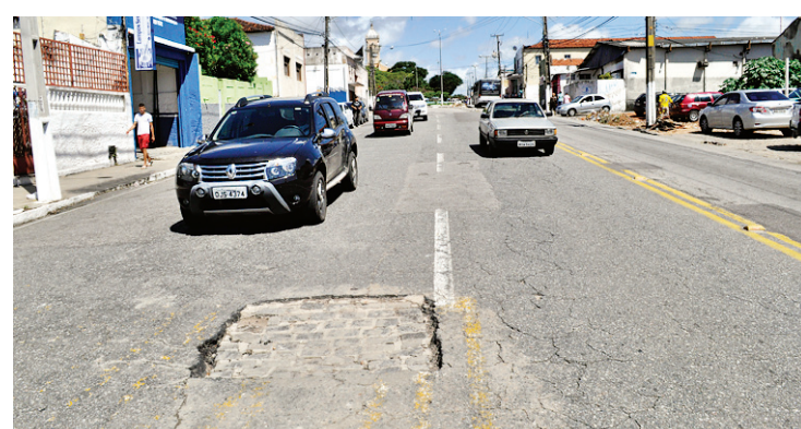
Avenida Coronel José Bernardo, próximo à Igreja São Pedro, no sentido Alecrim-Centro. Bem no centro da pista, o buraco preocupa motoristas e condutores de moto que têm que desviar da cratera logo após uma curva. O local é passagem certa para todas as linhas de ônibus que se dirigem ao Alecrim. Do outro lado da Igreja, na Rua Olinto Neto, a situação é outra: o asfalto está um tapete. Tudo foi recapeado.
