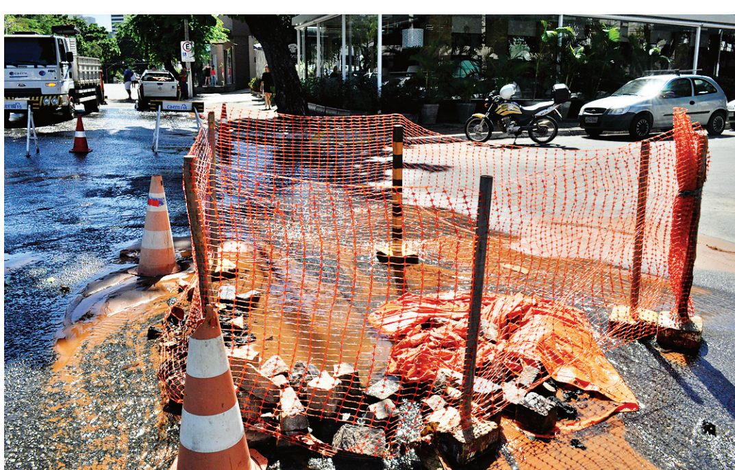
Avenida Afonso Pena, próxima ao restaurante Agaricus. Após um rompimento da tubulação de água, na manhã de ontem, a via cedeu com o peso de uma van de Acari, criando um buraco com cerca de 5 metros de comprimento, por 3m de largura e 1m de profundidade. O reparo foi iniciado ainda ontem, com previsão de ser concluído até as 15h. O recapeamento estava previsto na intervenção.
