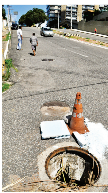
Avenida Deodoro da Fonseca encontrando com a Rua General Cordeiro de Farias. Não é exatamente um buraco, mas oferece grande risco para os motoristas. No local há uma boca de lobo sem tampa que, segundo um empresário da região, foi roubada. O local está sendo protegido por um cone laranja e um pedaço de paralelepípedo. A menos de um metro dali, bem próximo ao canteiro, há um buraco e este está sinalizado com um pedaço de madeira e um tecido vermelho.
