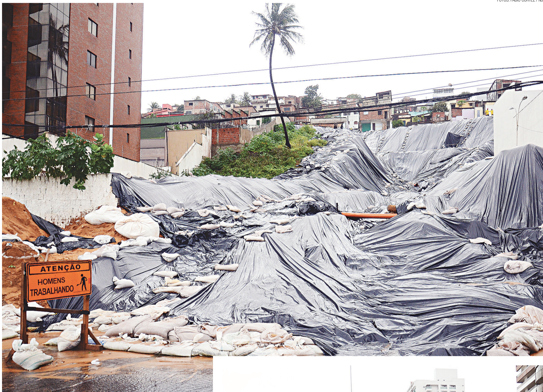
▶ Área de deslizamento em Areia Preta ainda é muito instável
