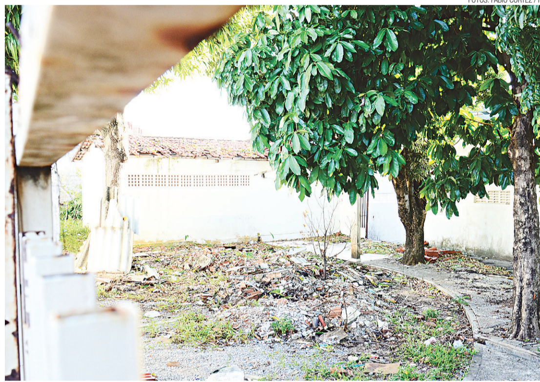
► Mato e lixo ocupam a Casa do Albergado, e vizinhança levou parte do telhado e equipamentos
