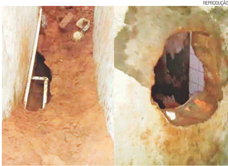
► Buraco por onde três detentos fugiram sexta-feira do Complexo João Chaves
