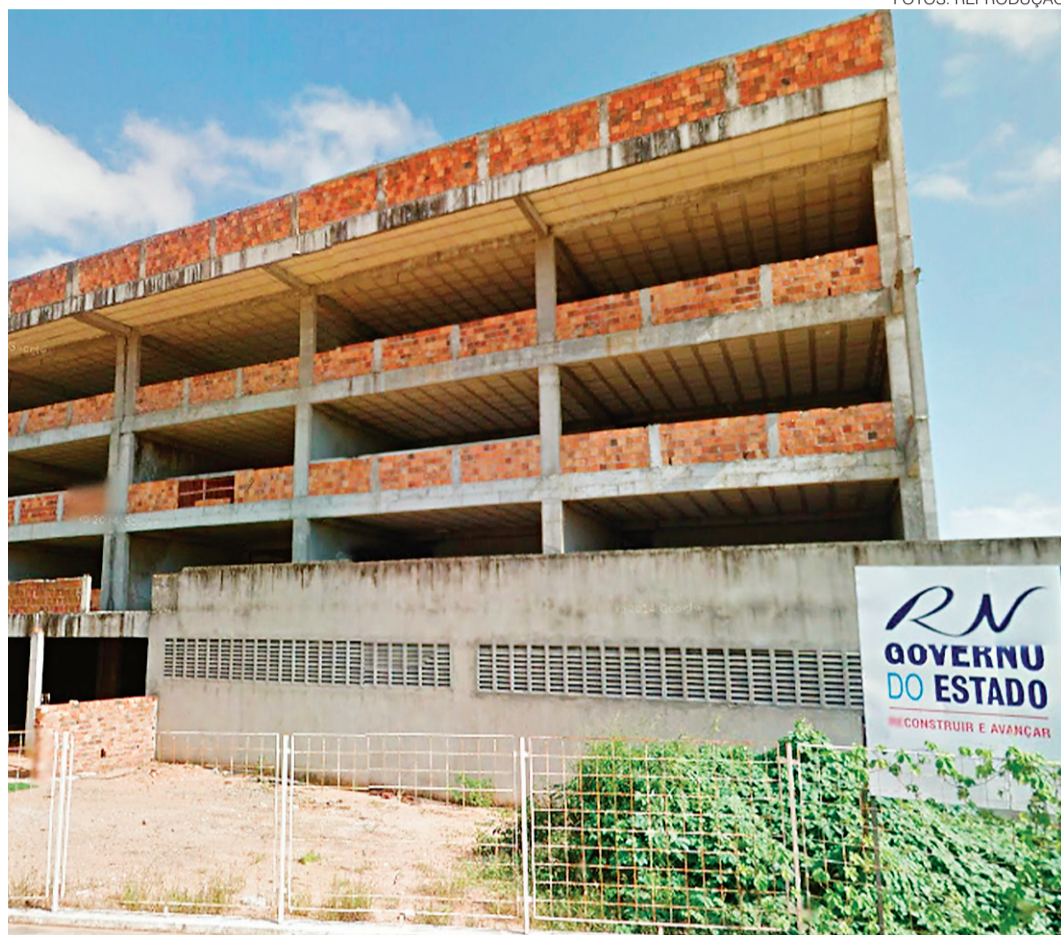
// Obra na nova sede da instituição em Natal, na Zona Norte, depende de liberação de recursos do Proinvest
