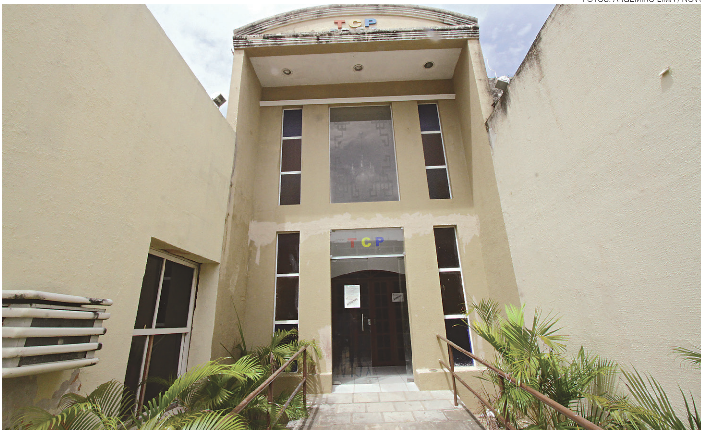
// O TCP foi fechado, em agosto de 2015, após a detecção de falhas no sistema de segurança e nas instalações elétricas do prédio
