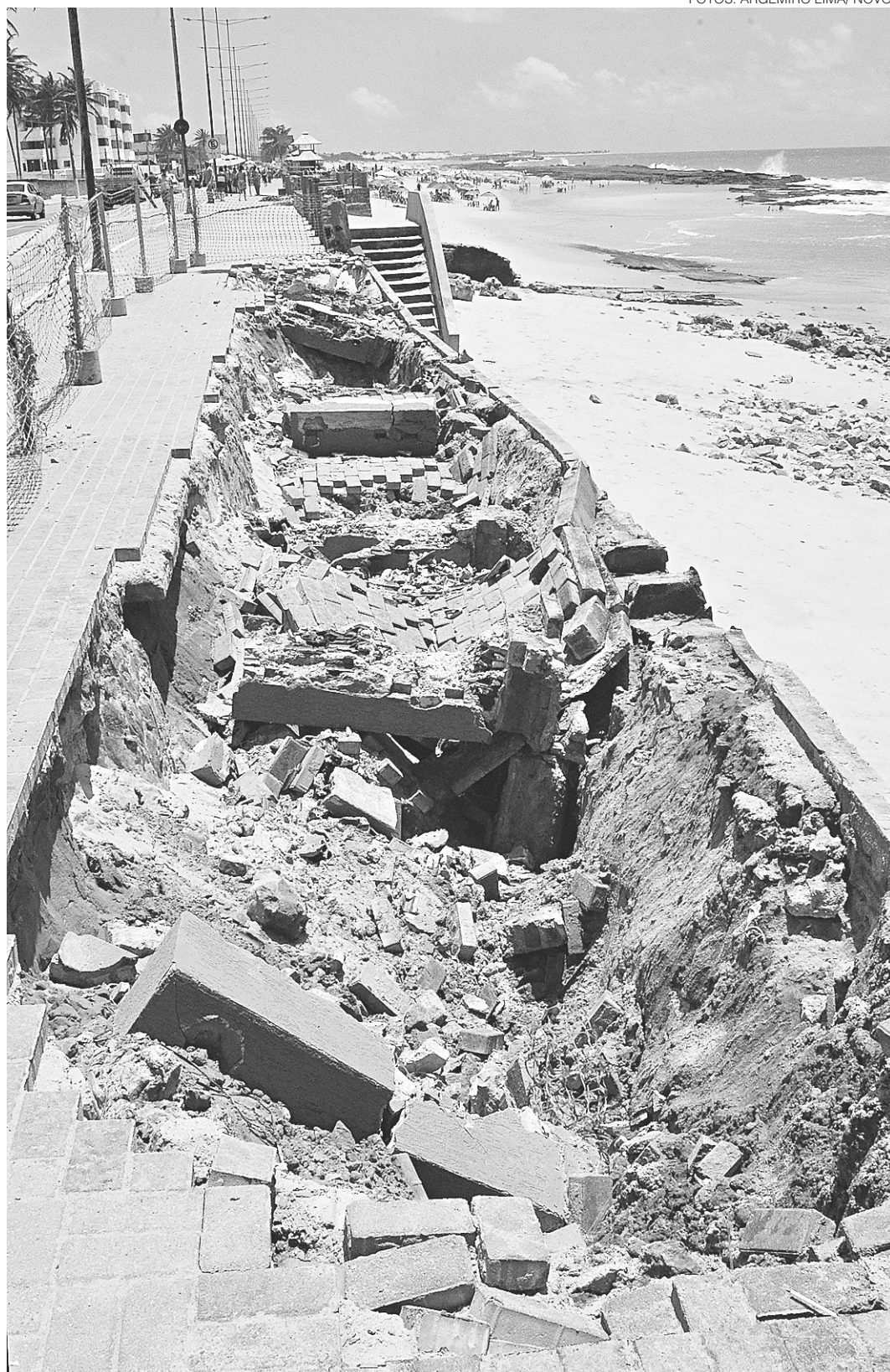
// Trecho crítico do calçadão da Praia do meio se estende por 450 metros, com risco de mais desabamentos
