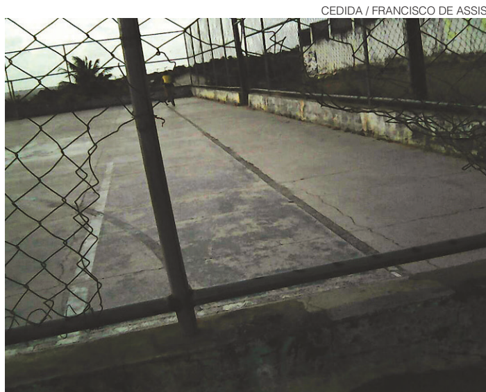
// Piso da única quadra do bairro está repleto de rachaduras e sujeira
