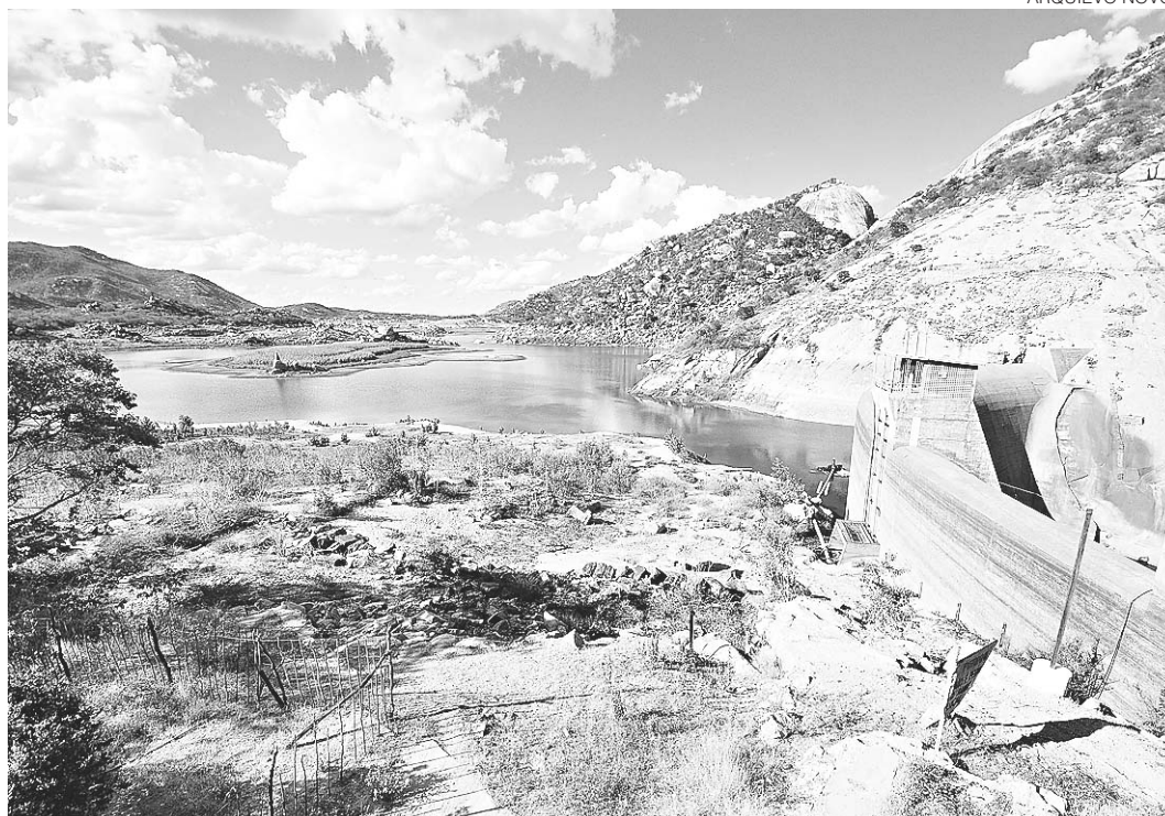
// Açude Gargalheiras, em Acari, apresenta trincas na sua estrutura e também está quase vazio
