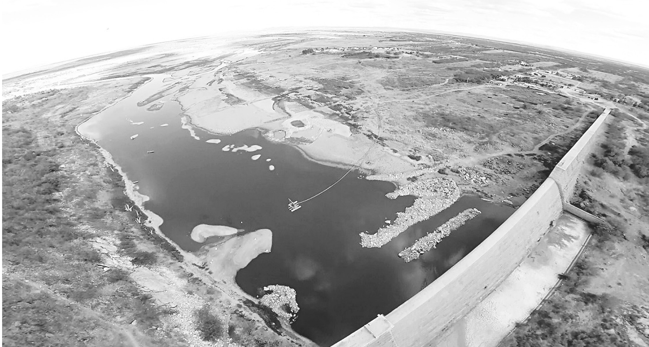
// Barragem Passagem das Traíras, em São José do Seridó, apresenta problemas de segurança com relação à qualidade do concreto, mas como no momento está com 0,01% de sua capacidade, não há risco de ruptura
