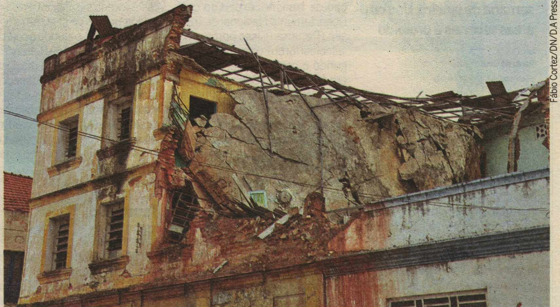
Edificação histórica localizada no cruzamento entre a Rua Chile e a Travessa Venezuela já desabou parcialmente
