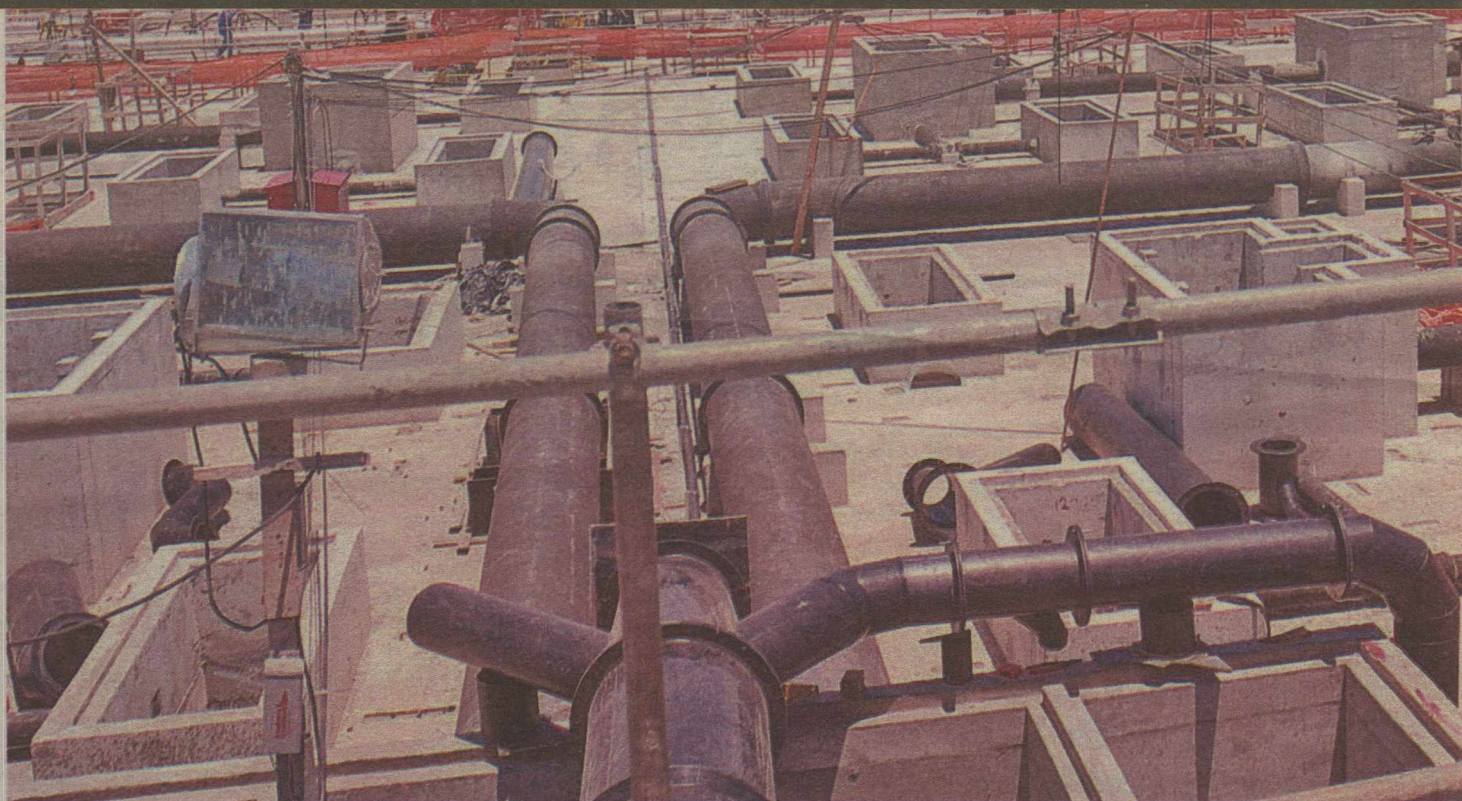
Com a maior Estação de Tratamento de Esgotos do NE funcionando em Natal ainda este mês, cenário do saneamento vai começar a mudar
