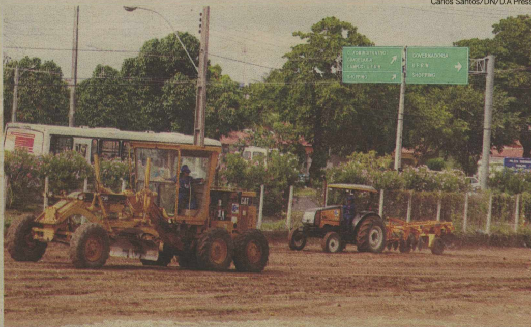
Terraplanagem na entrada do Centro Administrativo foi a única obra até o momento para a Copa de 2014
