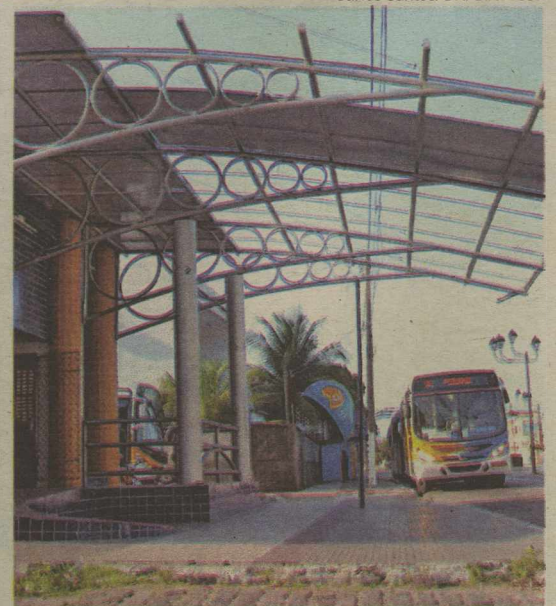
Nas Rocas, cobertura totalmente danificada expõe usuários
