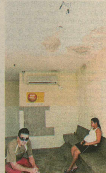
Posto tem infiltrações no teto
