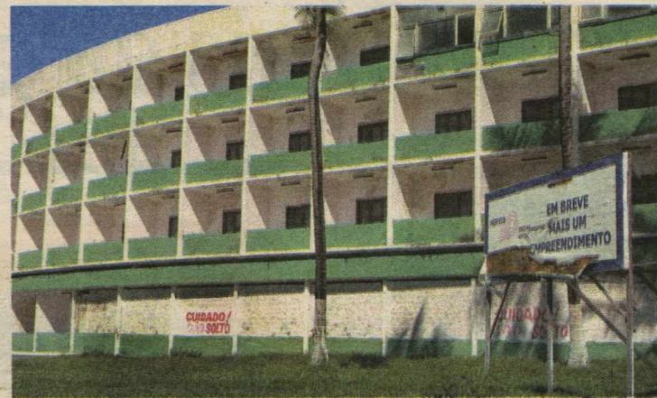
Prédio sofre efeitos do tempo enquanto projeto de revitalização não acontece
