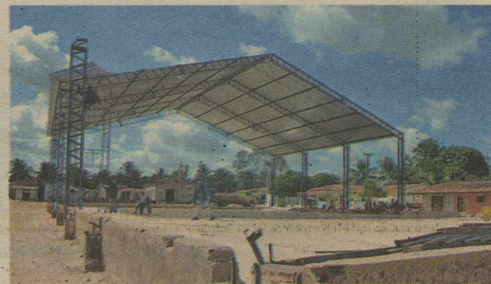
Teto da praça esportiva do distrito de Dom Marcolino desabou na quinta-feira
