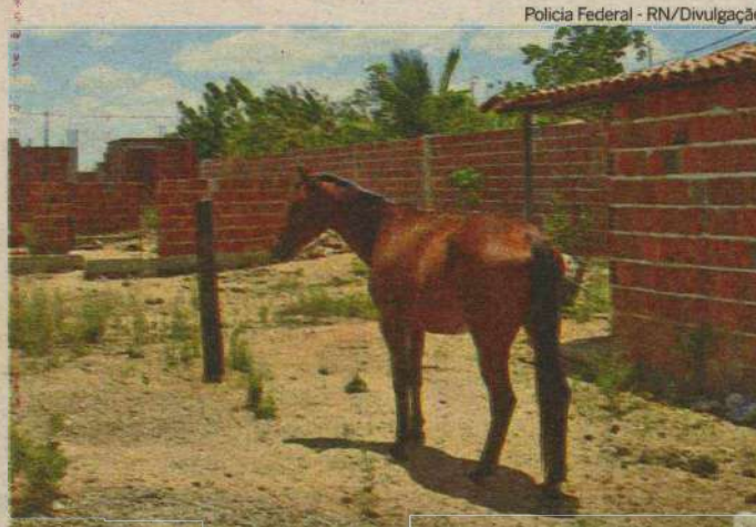
No local onde deveria estar a creche há entulho, mato e paredes pela metade
