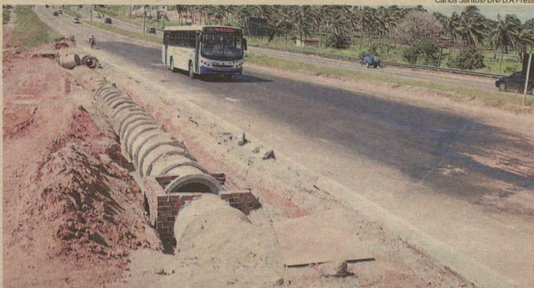
Fase seguinte, orçada em R$ 4,5 milhões, servirá para drenagem da pista e canalização do rio Pitimbu
