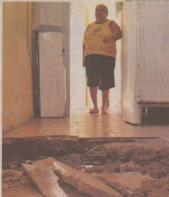
Buraco que dá acesso à rede de esgoto seria a principal causa do problema
