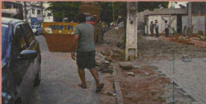
Já na Apodi, passeio é obstruído por entulhos e materiais de construção
