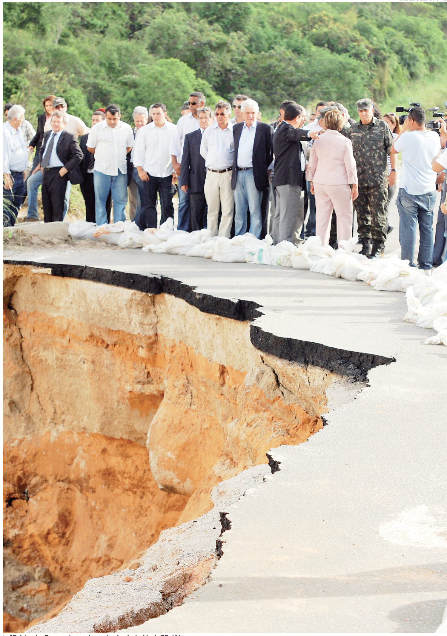
► Ministro dos Transportes conheceu trecho destruído da BR-101
