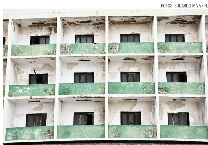
▶ Detalhe da fachada do Hotel Reis Magos, completamente deteriorada
